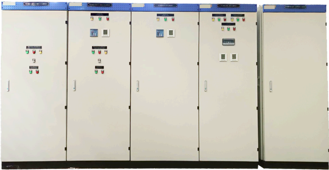
Tủ điều khiển động cơ Motor Control Center
